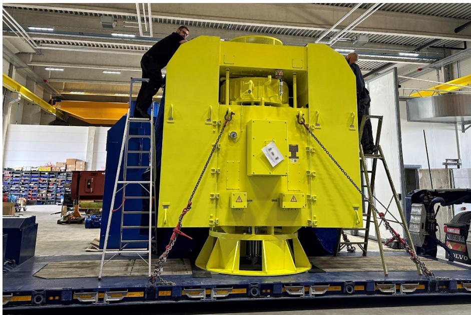
Bild: Der Vertikalmotor trägt auch die Pumpe und ist entsprechend robust ausgelegt
